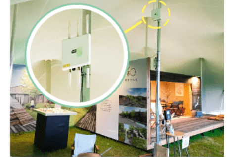
▲会場内に設置されたアクセスポイント
