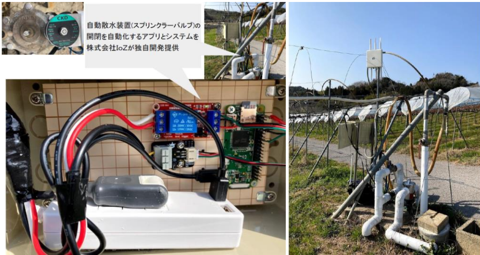
自動散水装置（スプリンクラーバルブ）の開閉を自動化するアプリシステムを株式会社loZが独自開発提供
